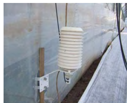
Sonda temperatura lato serra
