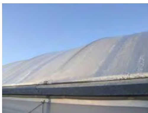
Grondaie installate per il recupero dell'acqua
