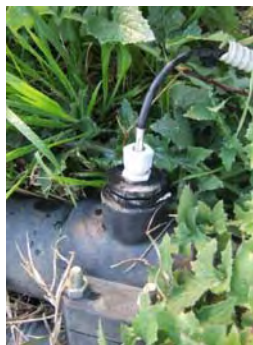
Sonda temperatura acqua pozzo
